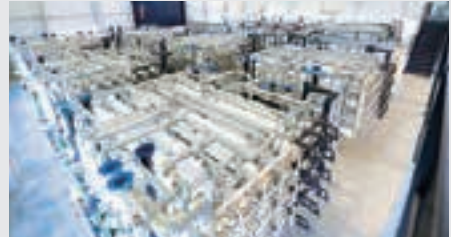
超純水製造装置
