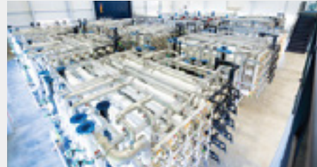
超純水製造装置
