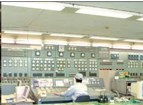
特高受変電所監視室
