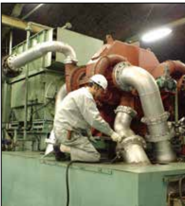
コンプレッサーの点検・整備
