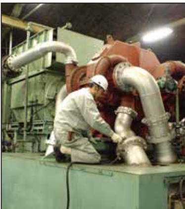
コンプレッサーの点検・整備
