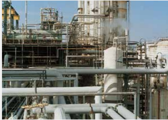
プラント建設からメンテナンスまで
