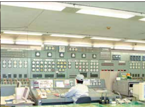
特高受変電所監視室
