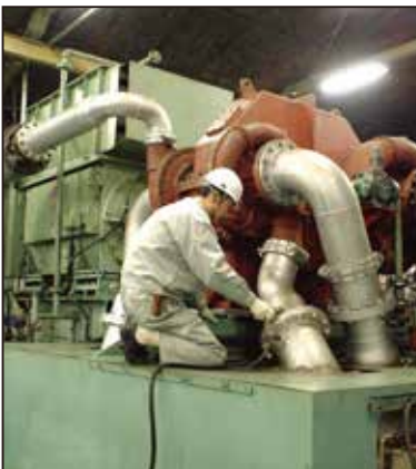
コンプレッサーの点検・整備
